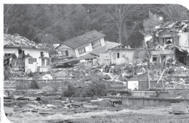
Zona afectada por un terremoto
